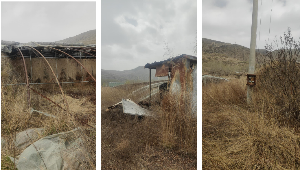
现状棚主体破损严重
