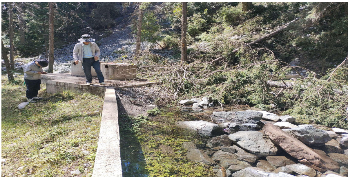
已建引水口运行良好
