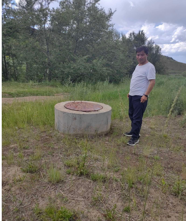
已建蓄水池运行良好无检查井检修不方便
