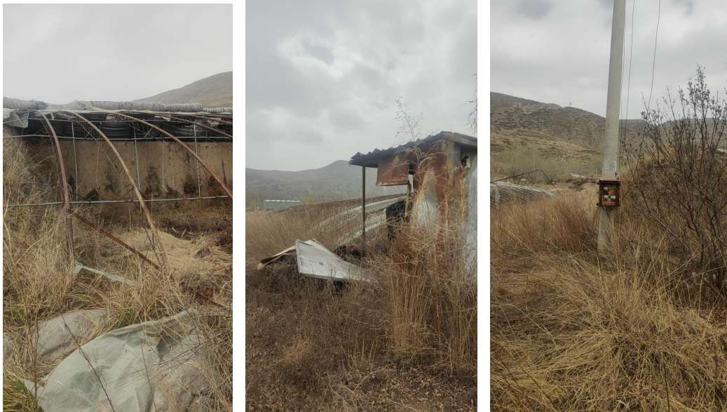
现状棚主体破损严重
